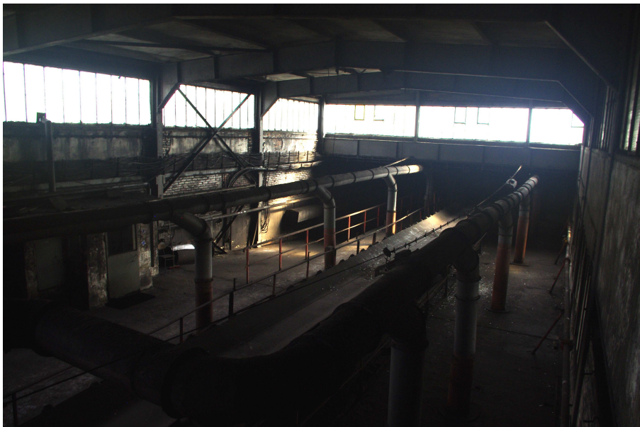
Fot. 16 Budynek główny Zakładu Przeróbki Mechanicznej Węgla - przenośnika taśmowego rewersyjnego nad zbiornikami w segmencie nr 6.
