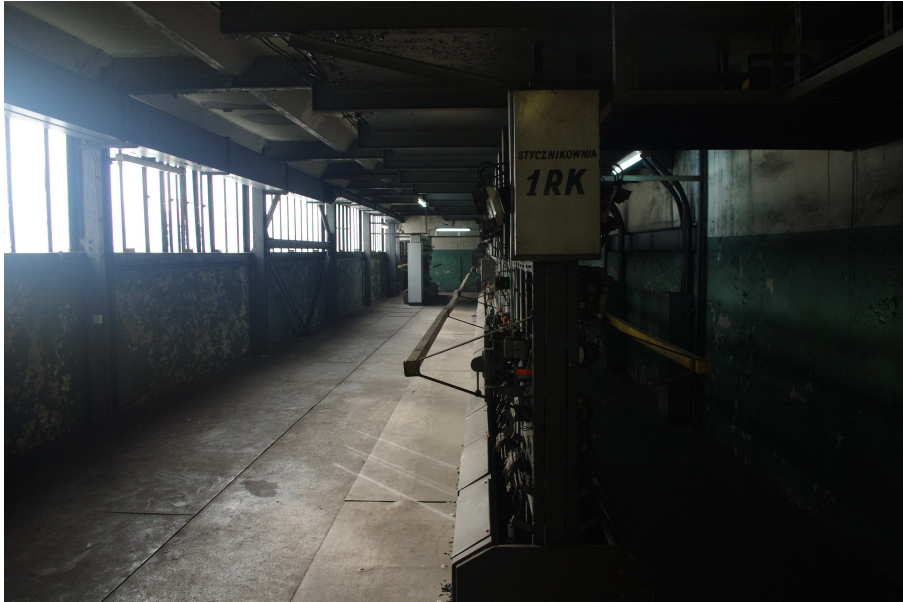
Fot. 15 Budynek główny Zakładu Przeróbki Mechanicznej Węgla - rozdzielnia w segmencie nr 8.
