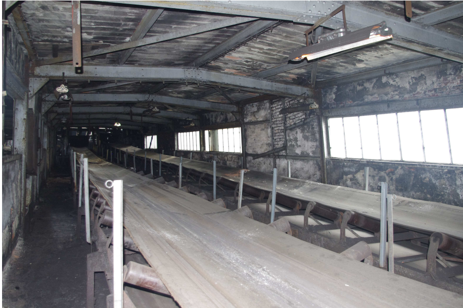
Fot. 29 Budynek główny Zakładu Przeróbki Mechanicznej Węgla - przenośniki taśmowe w segmencie nr 10.
