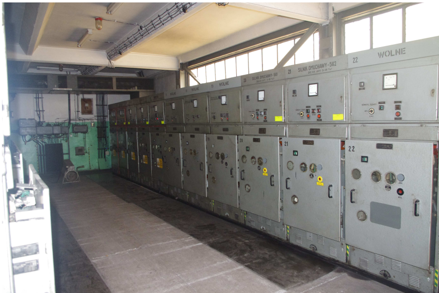
Fot. 14 Budynek główny Zakładu Przeróbki Mechanicznej Węgla - rozdzielnia w segmencie nr 5.
