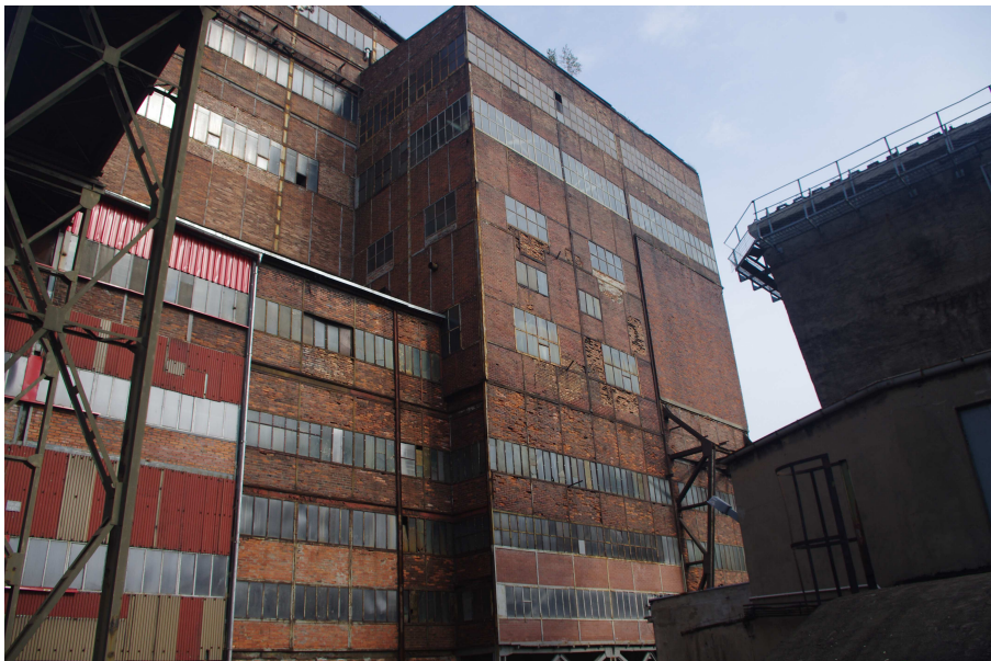
Fot. 42 Budynek główny Zakładu Przeróbki Mechanicznej Węgla - widok od strony południowo-zachodniej, widoczne segmenty nr 20; 14 oraz 21.
