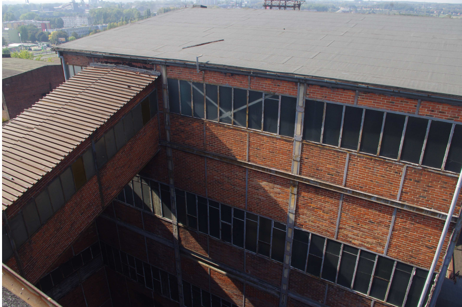
Fot. 31 Budynek główny Zakładu Przeróbki Mechanicznej Węgla - segment nr 14 i pomost (segment nr 15), widok od strony północno-wschodniej.
