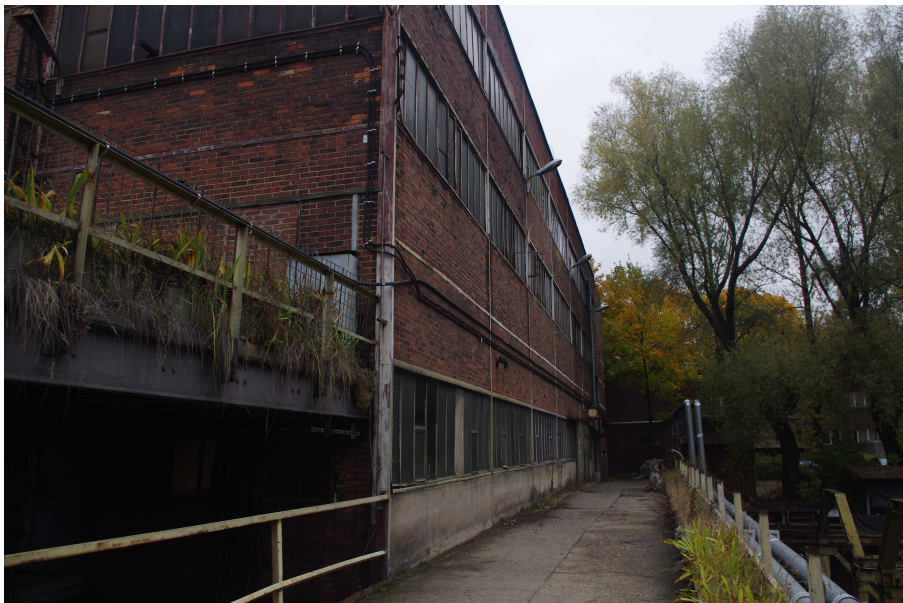
Fot. 20 Budynek główny Zakładu Przeróbki Mechanicznej Węgla - widok z rampy (ze strony południowo-wschodniej) na segment nr 8.
