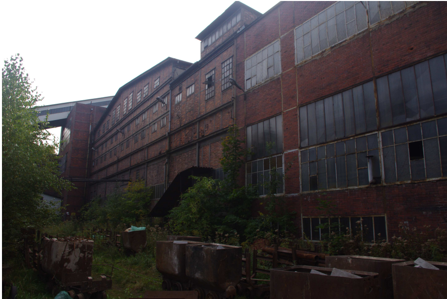
Fot. 5 Budynek główny Zakładu Przeróbki Mechanicznej Węgla - widok od strony północno-zachodniej na segmenty nr 1; 2; 3 i 4.
