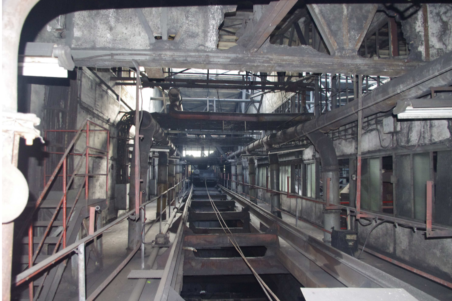
Fot. 9 Budynek główny Zakładu Przeróbki Mechanicznej Węgla - przestrzeń nad zbiornikami w segmencie nr 3.
