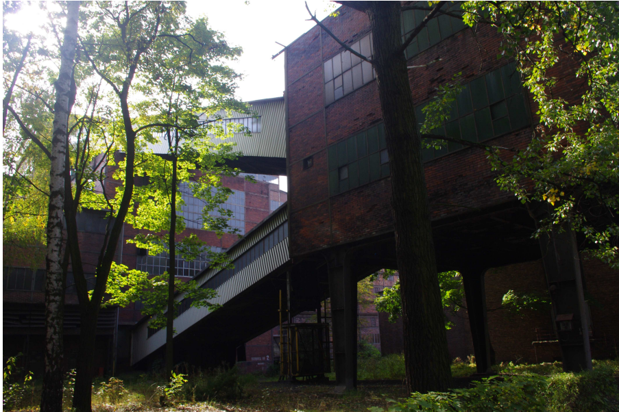
Fot. 49 Most przenośnikowy - widok od strony północno-wschodniej, po lewej stronie widoczna stacja przesypowa, która nie podlega rozbiórce.
