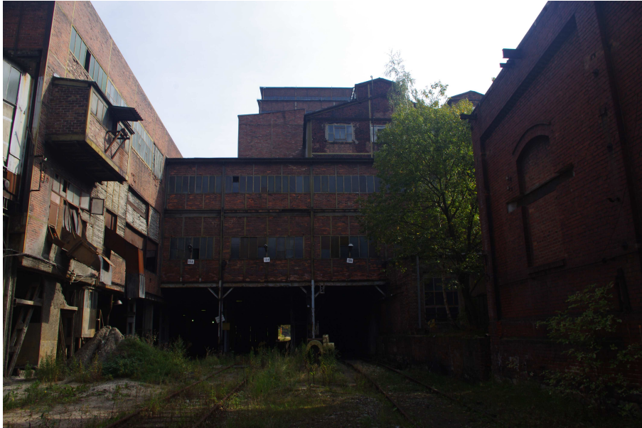
Fot. 23 Budynek główny Zakładu Przeróbki Mechanicznej Węgla - widok od strony zachodniej, na pierwszym planie segment nr 11, w głębi segment nr 12, 18 i 14, po lewej stronie segment nr 9.
