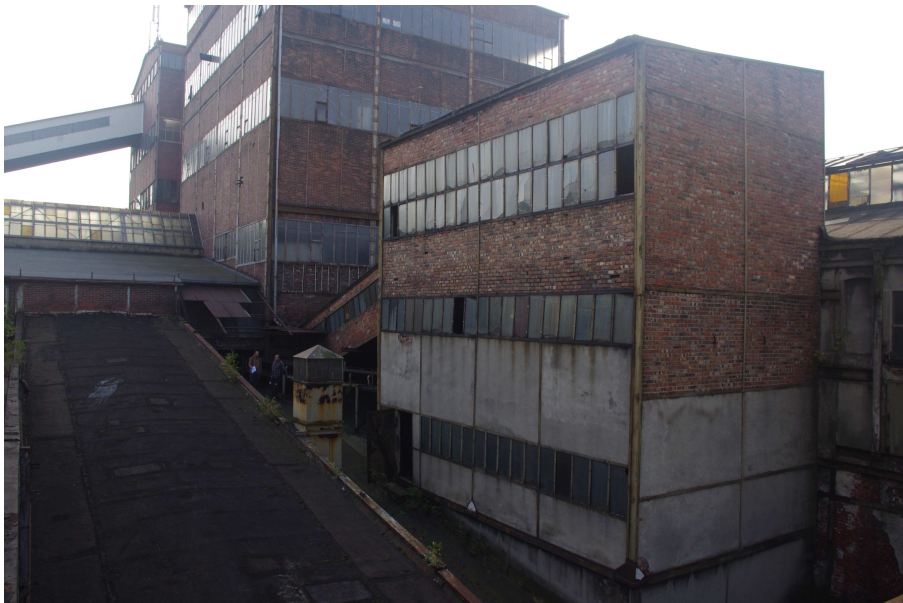
Fot. 26 Budynek główny Zakładu Przeróbki Mechanicznej Węgla - widok od strony północno-zachodniej na segment nr 12, w tle segment nr 14 i łączący je pomost - segment nr 13.
